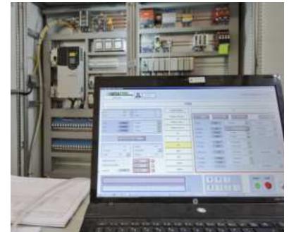
Pannello elettrico con una vista di un sistema software di controllo PLC.
